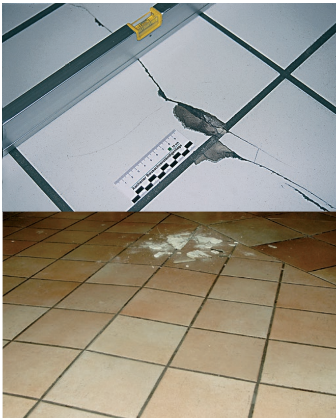
Schuifspanningen door verschillende uitzettingscoëfficiënten tussen de tegelvloer en de ondergrond of door nieuwe, nog bewegende dekvloeren veroorzaken scheuren en welvingen in de tegellaag.
